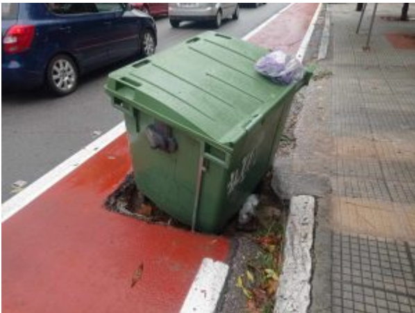
Κέντρο Βόλου. Κατεστραμμένα οδοστρώματα.
