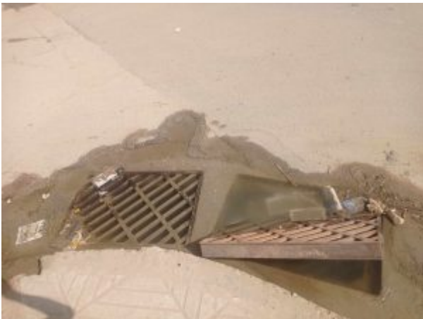
Βουλωμένα φρεάτια σε κεντρικό δρόμο.
